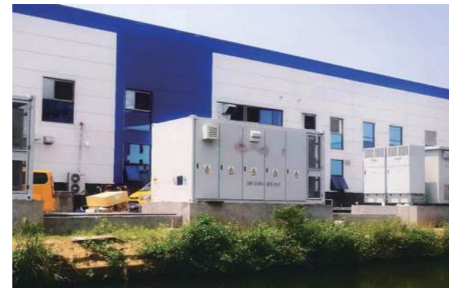
• 安徽 DH200F 5MW/18MWh 动态扩容+光伏消纳
