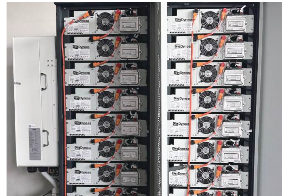
• 保加利亚 PowerRack HV4F 112.64 kWh 峰谷套利+自发自用
