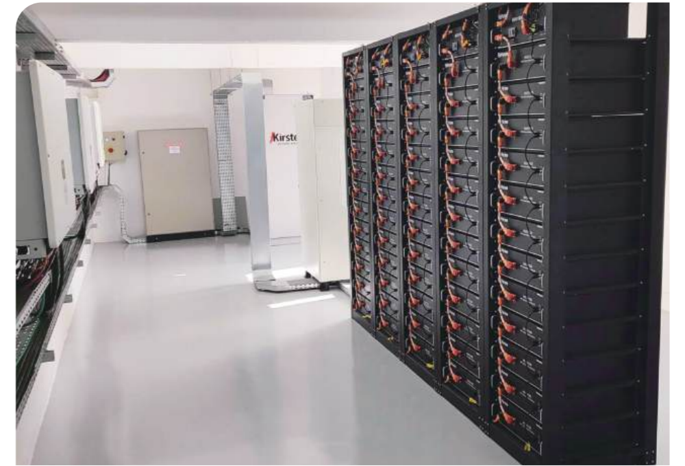
• 巴西 PowerRack HV4 100kW/307kWh 动态扩容+光伏消纳
